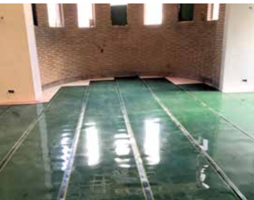
Infrarood vloerverwarming in de kerk.
